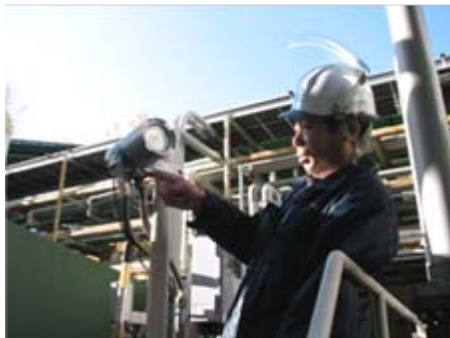
2009年12月 D棟放流槽 pH異常
