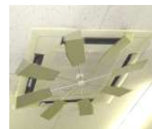
ハイブリットファン (事務所の空調)
